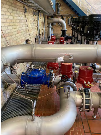
Figur 7: Prøvehaner på afgang værk og nødforbindelse
