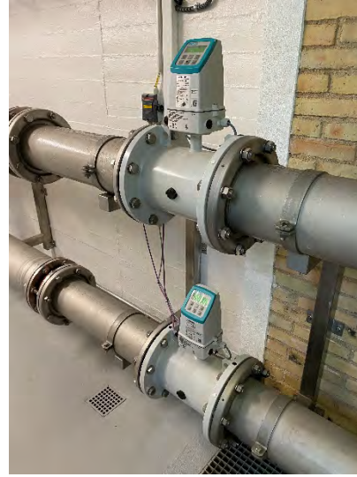
Figur 8: Vandmåler afgang værk og nødforbindelse
