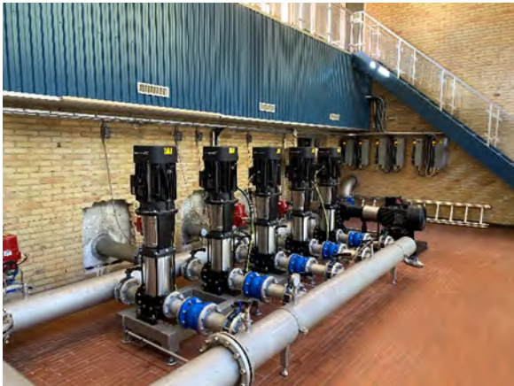
Figur 9: Skyllenvands- og rentvandspumper
