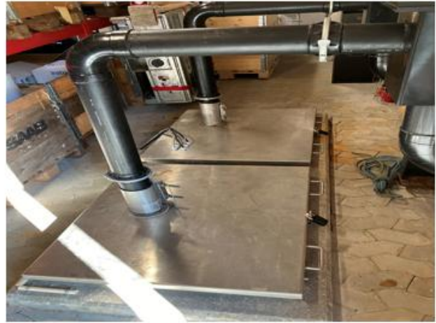
Figur 12 – Nedgang til rentvandstank - Lukket
