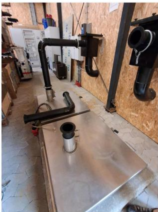
Figur 11: Rentvandstank med låg på og ventilationsrørret pillet af.
