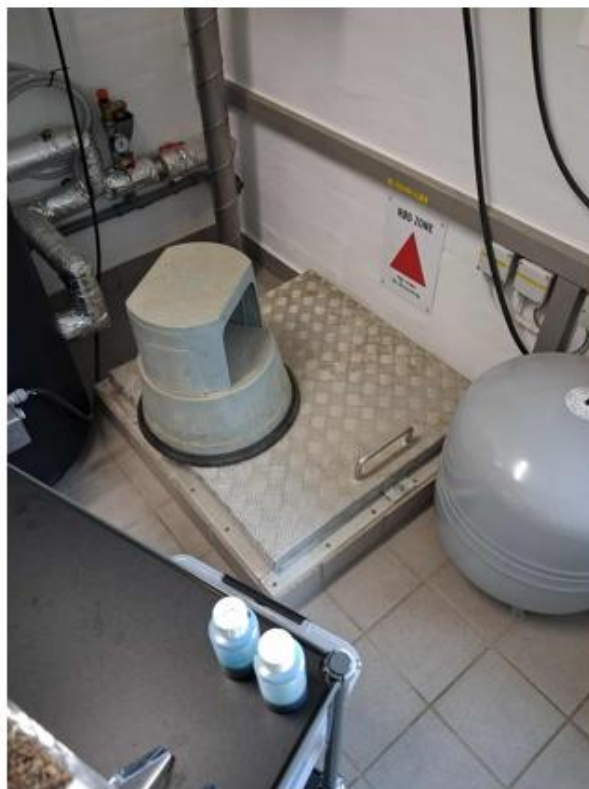
Figur 14: Anden låge til rentvandstank
