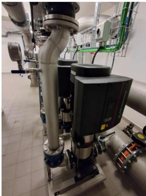
Figur 5: Rentvandspumper , afgang vandværk, UV mm.
