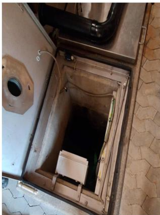
Figur 12: Rentvandstank med åbent låg
