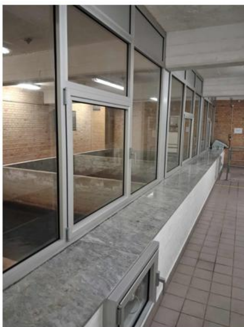
Figur 3: Åbne filteranlæg afskærmet af glas
